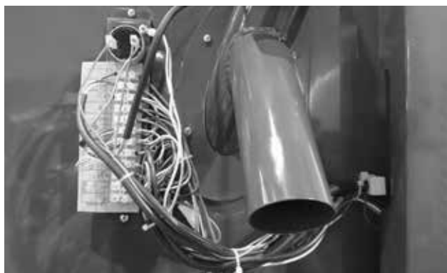
Электропроводка под передней панелью обшивки котла
